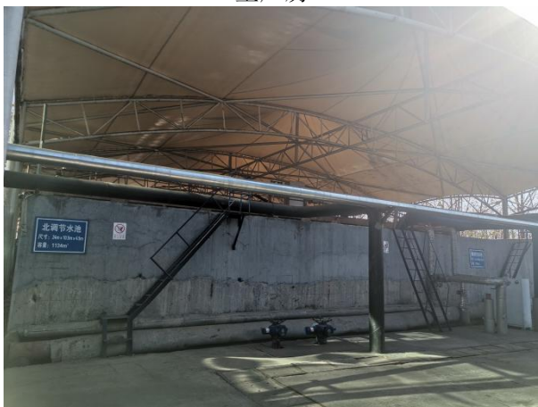
矿井水处理站
