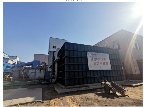
生活污水处理站
