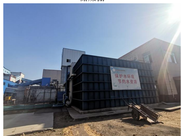
生活污水处理站
