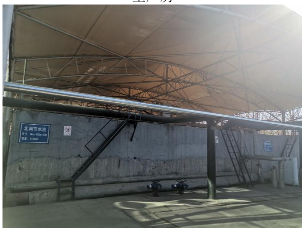
矿井水处理站
